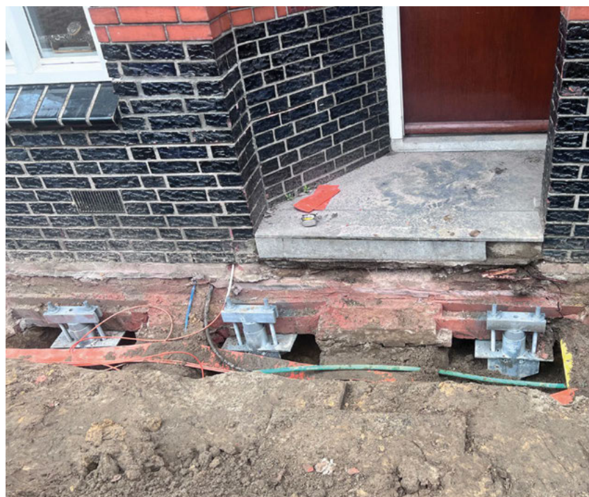
Met behulp van speciale verbindingstukken, de zogeheten brackets, wordt de last van de fundering op de palen overgebracht. (foto Duurzaam Funderingsherstel)
